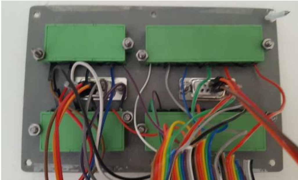
Figura 2.20: Cableado de entradas analógicas y digitales.
